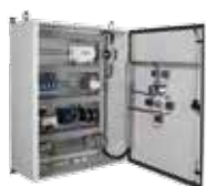
Coffrets de puissance et de régulation standard
